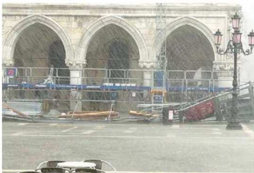
L'impalcatura di protezione del cantiere di Palazzo Ducale caduta (foto Andrea Venturini)
